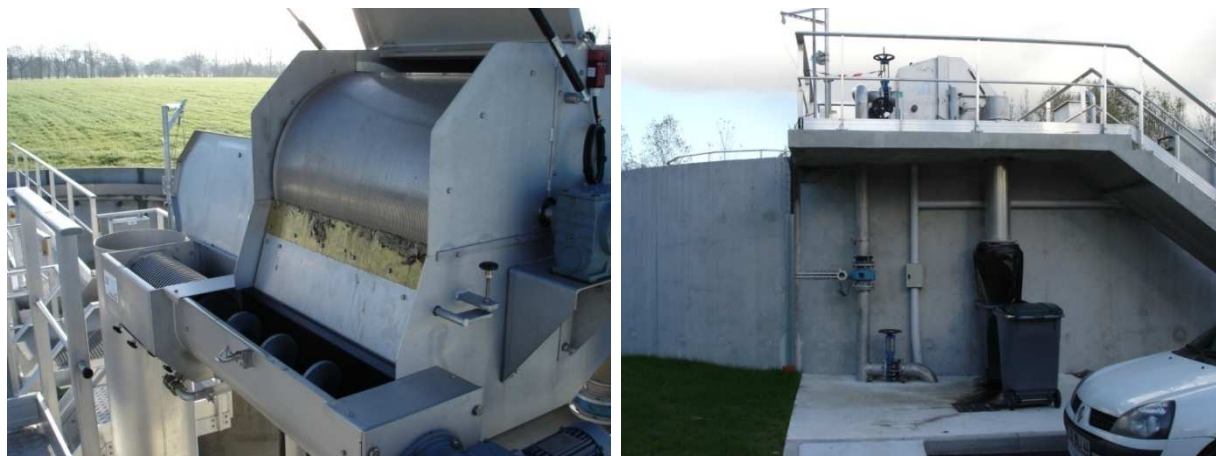
Figure 17 : Illustration - Tamis rotatif - Compactage et stockage des refus de tamisage en benne
