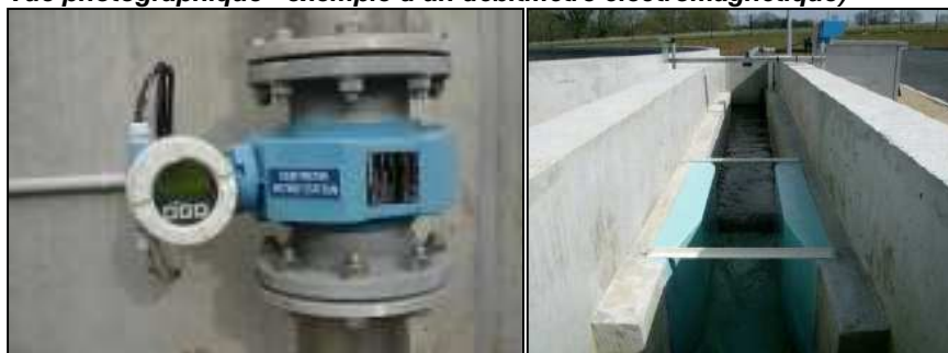
Figure 34 : Vue photographique - exemple d'un débitmètre électromagnétique)
